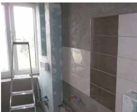
Die Rohrlei- tungen sind verkleidet, der WC Spülkas- ten ist eben- falls hinter Gipskarton.
